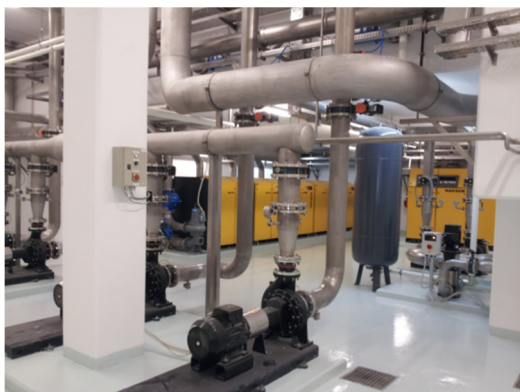
Slika 3: Strojnica nove CČN Novo mesto
