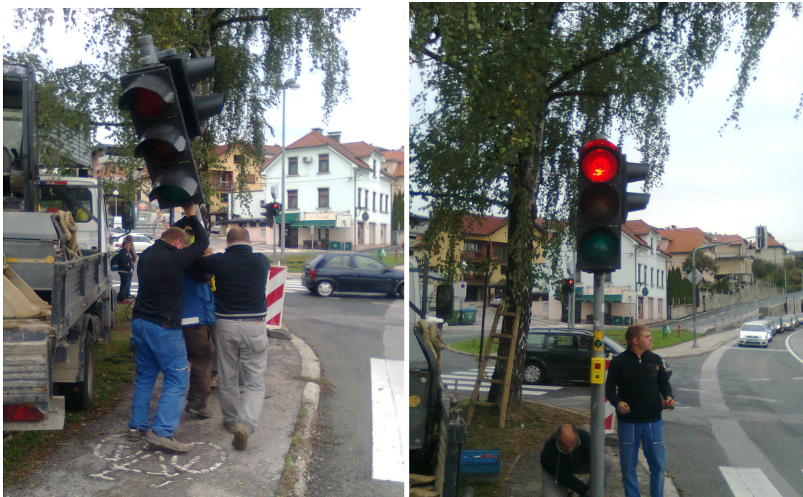
S29 in S30: Popravilo napajanja za semafor (stare cevi in kable so pregrizle podgane)
