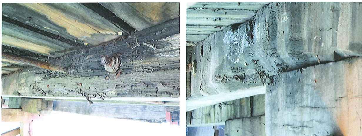
Slika 3.3 2. stopnja razkroja na posameznih vzdolžnih legah mostne konstrukcije, levo (VL3/D) in desno (VL4/C).
