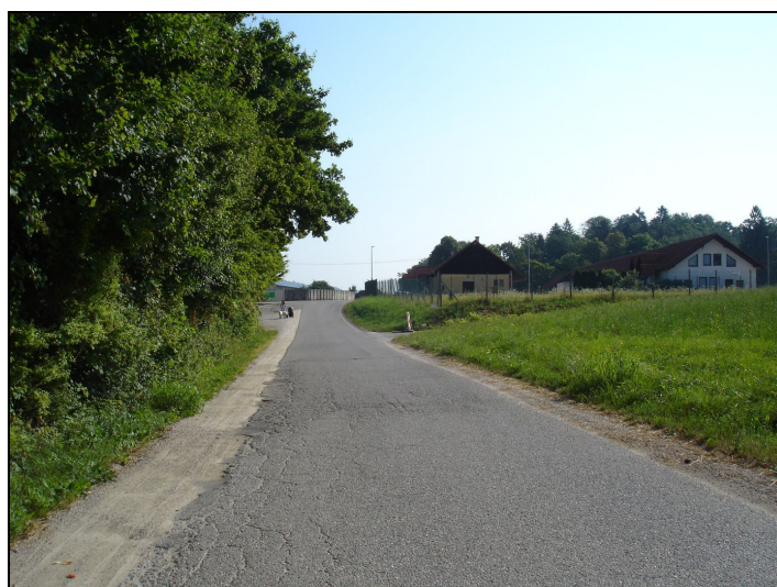
- pogled na slabo stanje obstoječe lokalne ceste -
